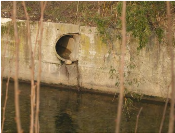
Fig.3.12 Scarico fognario di piena in sponda sn a valle di via Buozzi
