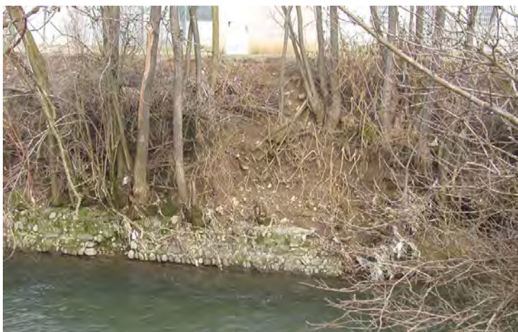
Fig.3.20 Vecchi argini in ciottoli a sud di via Milano
