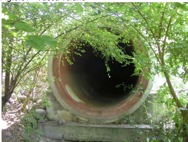
Fig.3.32 Tubazione di scarico attualmente inattiva
