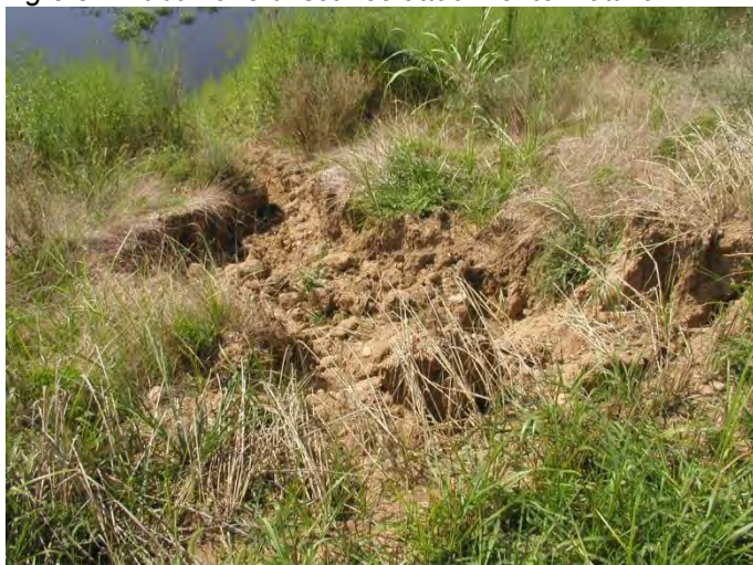
Fig.3.33 Erosioni a fossi sulle sponde della vasca
